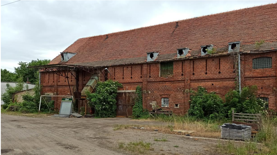
Rycina 17 Stan techniczny zabytkowego budynku spichlerza w zespole folwarcznym w Bierzwniku
